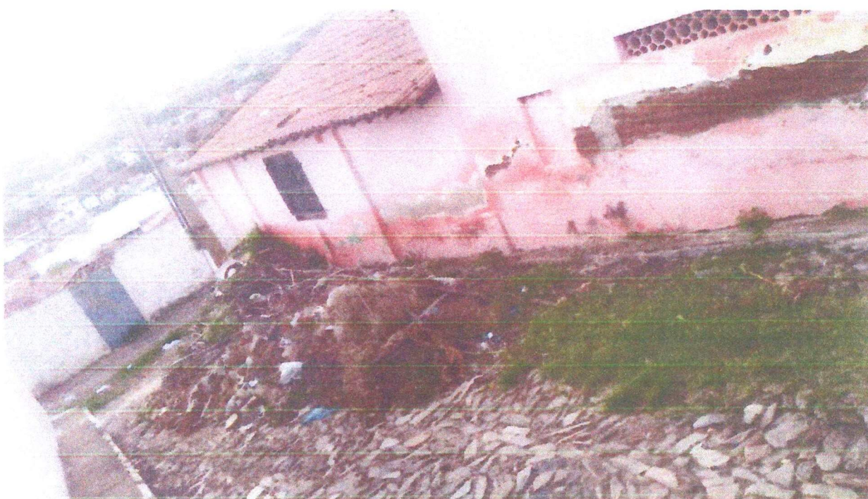
FOTOS DO BECO AO LADO DO ANTIGO PRÉDIO DO CENTRO DE ACOLHIMENTO AO LADO DO CSU MUITO LIXO-ENTULHO-PRÉDIO COM PAREDE ESTRAGADA
