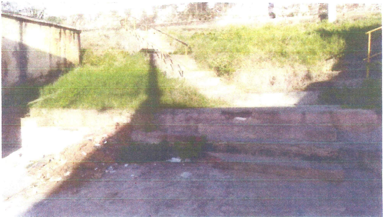
FOTOS DA ESCADARIA AO LADO DO CAPS DE ORÓS MATO-LIXO-CORRIMÃO QUEBRADO- DEGRAUS QUEBRADOS AO LADO DO REFEITORIO DOS PACIENTES DO CAPS
